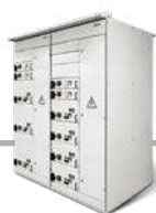
КРУ низкого напряжения и центр управления двигателями
