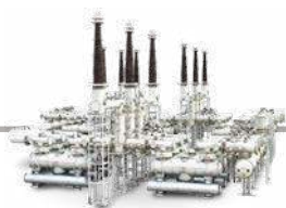
КРУ с газовой изоляцией
